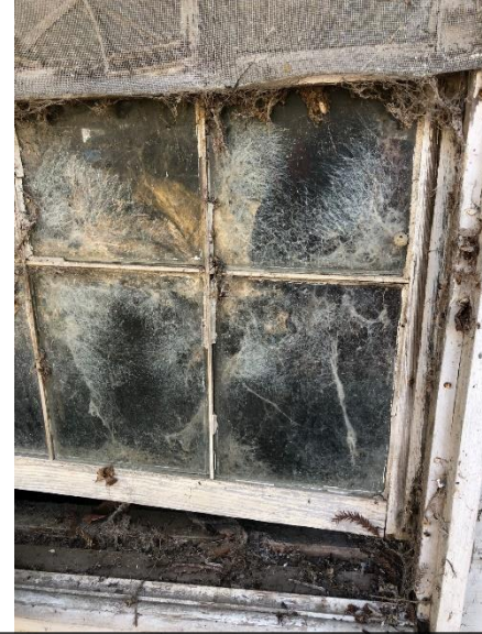
HA 1 – Window glazing
