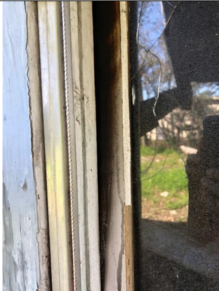
HA 2 – Window glazing
